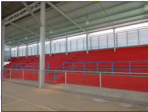
Panorámica de la construcción de las graderías en el costado oeste del Gimnasio de Balonmano.
